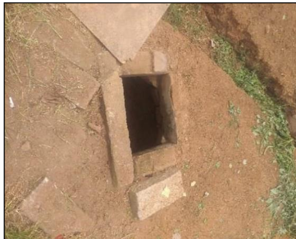
photo 1b : puits sans protection à
