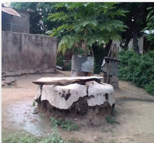
Photo 1a : puits dégradé à Gonfréville
