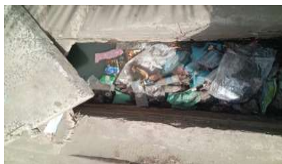
Photo 2 : Canal bouché par les ordures ménagères 17,45°W et 14,68°N
