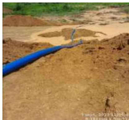
Photo 9 : Écoulement d'eau d'usage dans la végétation et le cours d'eau
